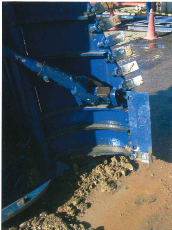
底ざらい用スクレーバ取付状況
